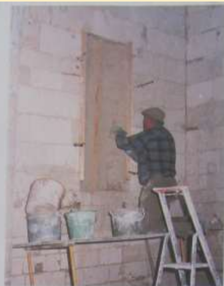
Constatant la dégradation des boiseries de l'autel de la Vierge, René sera contraint de les enlever et va rénover le mur correspondant.
