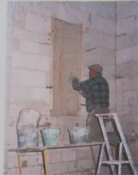
Constatant la dégradation des boiseries de l'autel de la Vierge, René sera contraint de les enlever et va rénover le mur correspondant.
