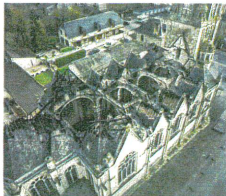
Soixante pompiers venus de tout le département et des départements voisins sont intervenus sur le site.
